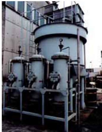
排水処理量：5 m 3 / h PCC-6A 充填：120 kg (40 kg × 3塔)
